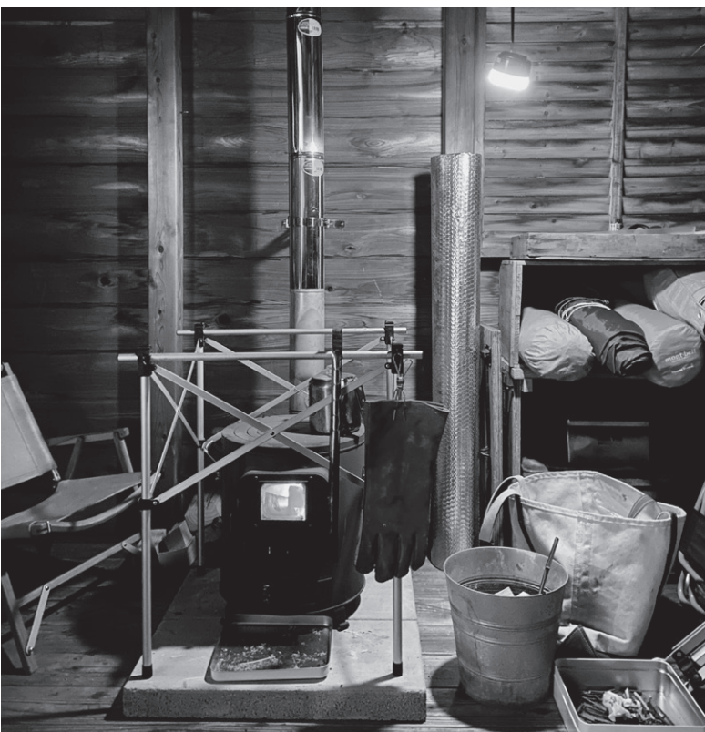
箕面森町の住宅で設置された薪ストーブ (榊田中工務店より写真提供)
