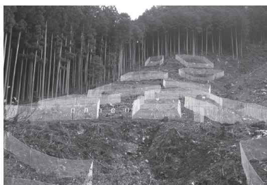
パッチディフェンスの施工事例(写真:宮川森林組合より提供)
