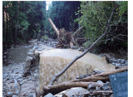
大きな被害を受けた林道
