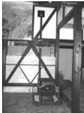
設置したストーブ(南河内支店)
