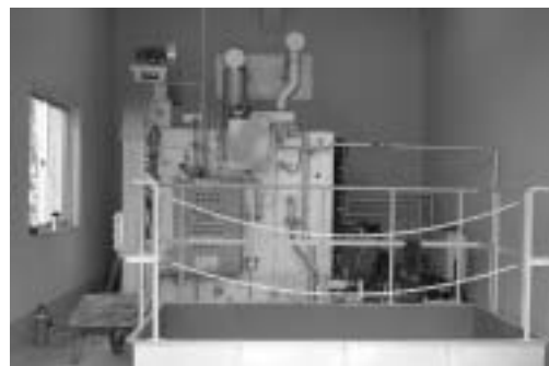
木質資源利用ボイラー
